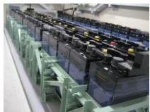
・蓄電池 ・後備蓄電池
