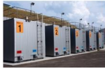
代替屋外給水タンク (T.P31mに設置)
