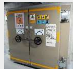
水密扉 (重要な機器がある エリアの入口)
