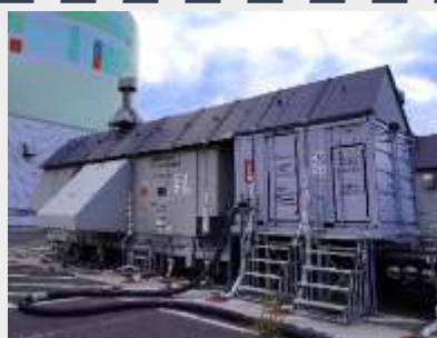
代替非常用電源（常設）6台を配備
