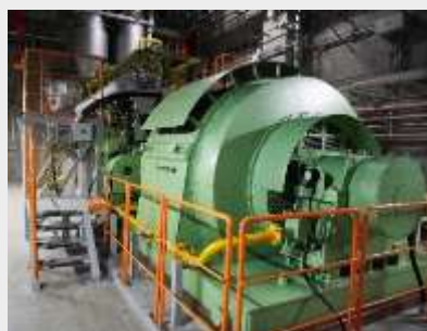
非常用ディーゼル発電機 （建設時点から1号機、2号機、 3号機にそれぞれ2台ずつ配備）
