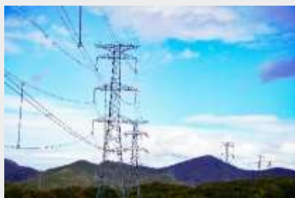
外部電源（送電線から受電）
