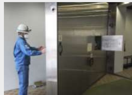
水密扉 (建屋入口)
